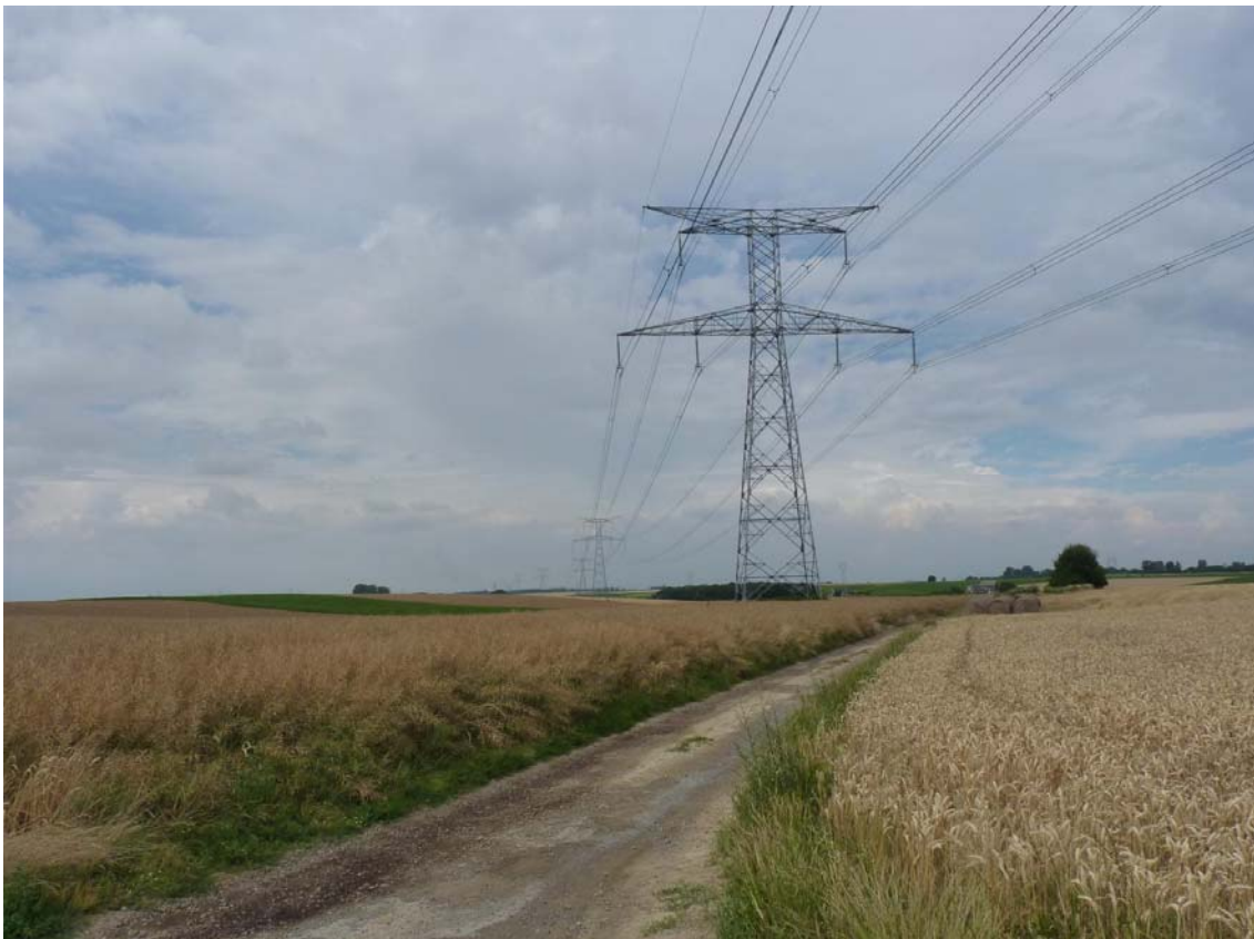
Photo 27 : Ligne à haute tension à l'Est de l'aire d'étude rapprochée
